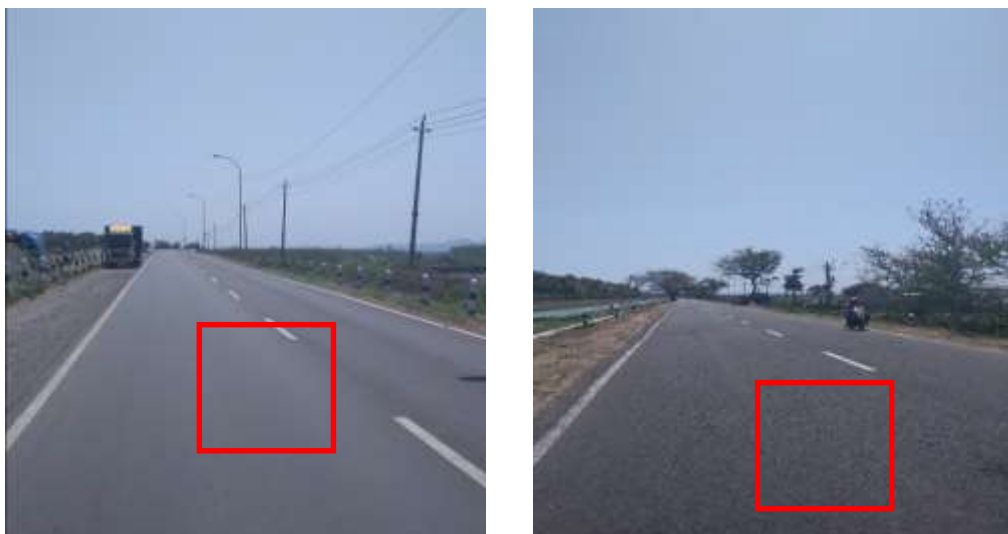
Gambar 4.8. Kondisi Bahu Jalan
