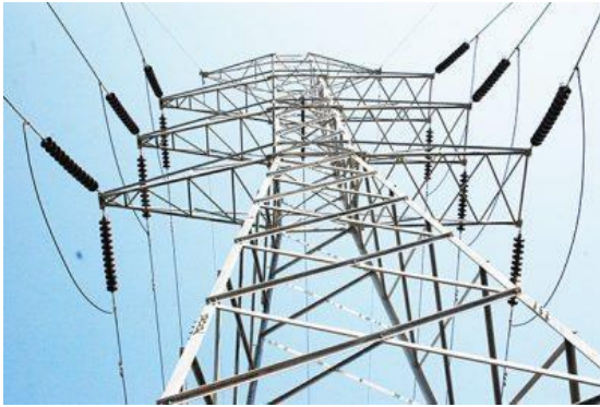
Gambar 2.2 Saluran Udara Tegangan Tinggi
