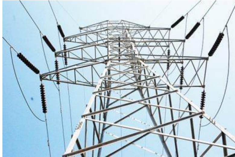
Gambar 2. 2 Saluran Udara Tegangan Tinggi Sumber : http://semarangpedia.com,2017
