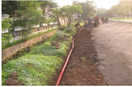
Gambar 2. 5 Saluran Kabel Tegangan Menengah
