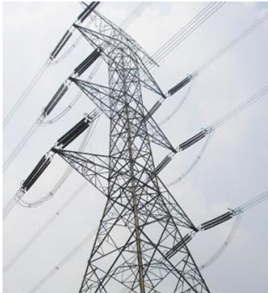
Gambar 2. 1 Saluran Udara Tegangan Ekstra Tinggi
