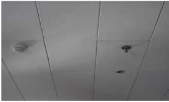
Gambar 5 Deteksi asap dan sprinkler
