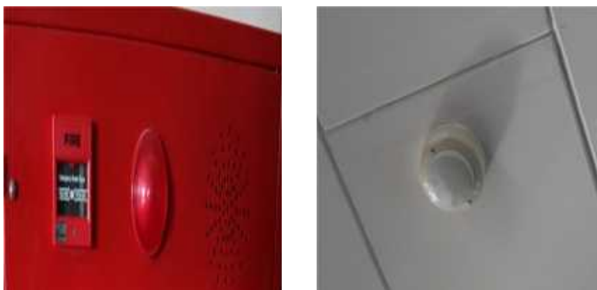
Gambar 4.8 Alarm dan deteksi Panas
