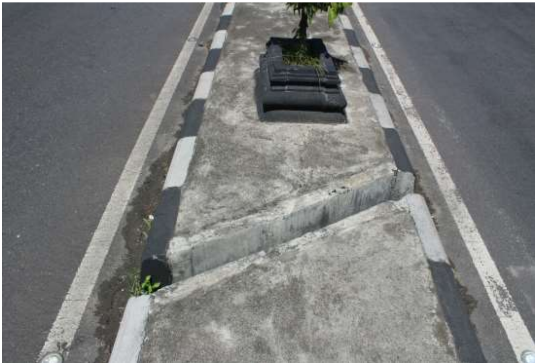
Gambar lampiran : 4. Foto kondisi pembatas jalan dan saluran limpasan air hujan
