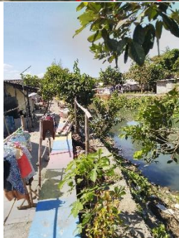
- Tanggul sungai pada pemukiman warga
