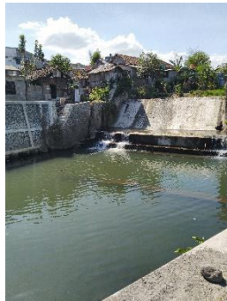
- Kondisi tebing DAM yang sudah rusak
