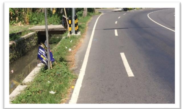
Gambar 4.14 Ukuran Bahu Jalan yang Kecil
