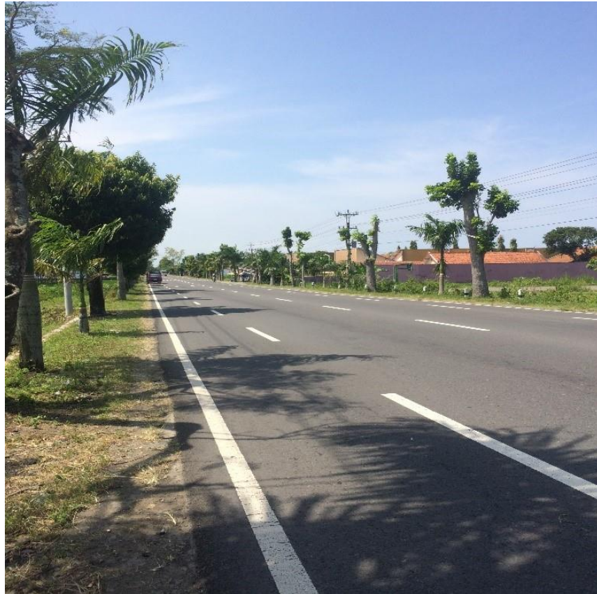
Gambar 4.21 Tidak Ada Rambu Peringatan Batas Maksimum Kecepatan
