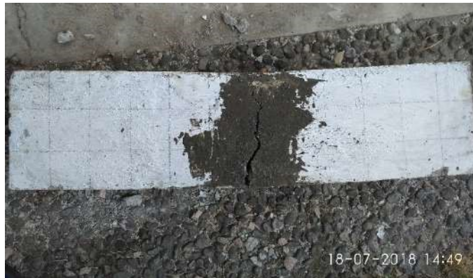
Gambar 4.7 Retak maksimum setelah perbaikan
