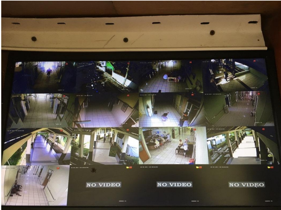
Gambar 1.7 Pantauan CCTV RS Panembahan Panembahan Senopati
