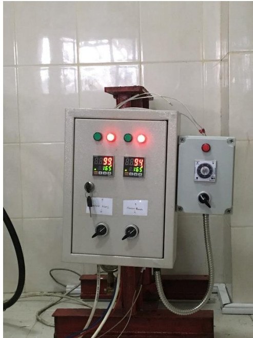
Gambar 3. 42 Temperatur Pada Control Box
