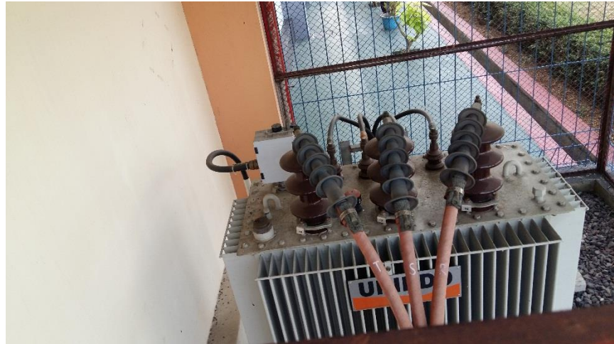
Gambar 2.5 Trafo Pemakaian Sendiri
