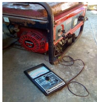
Gambar 3.13 Pengukuran Putaran Genset
