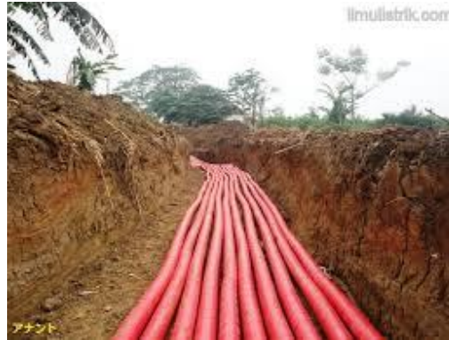
Gambar 2.8 Saluran Kabel Tanah Tegangan Menengah
