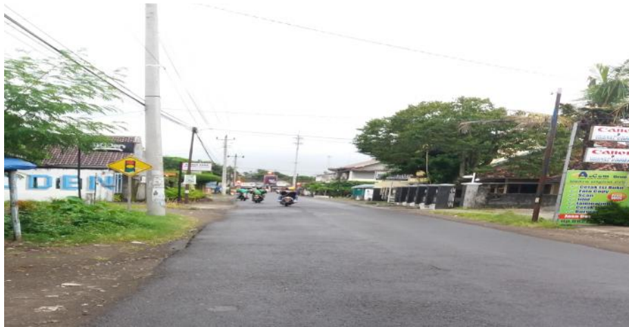
Gambar 4.21 Kondisi Jalan yang Tidak Terdapat Marka
