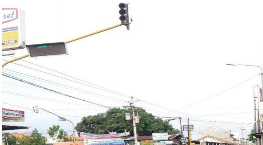
Gambar 4.24 Kerusakan pada APILL
