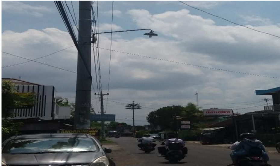
Gambar 4.23 Kondisi Lampu Penerangan
