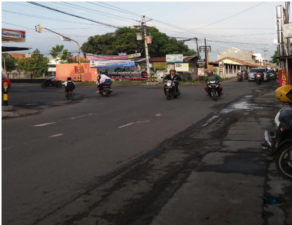
Gambar 4.20 Kondisi Marka Jalan yang Tidak Layak
