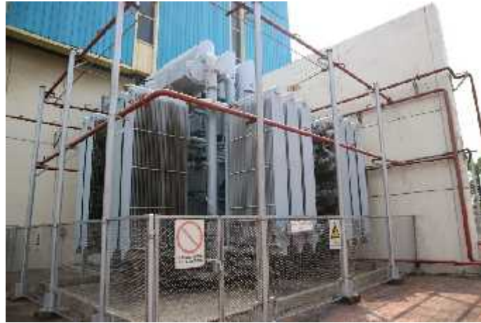
Gambar 2.1: Transformator Tenaga (Sumber: Dokumen Pribadi)
