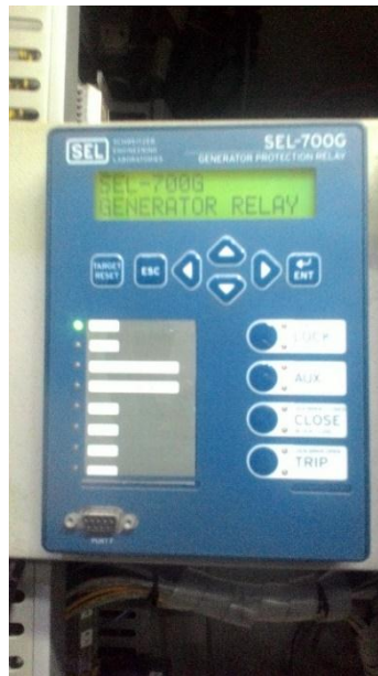
Gambar 4.2 Multifunction rele SEL 700G untuk Generator
