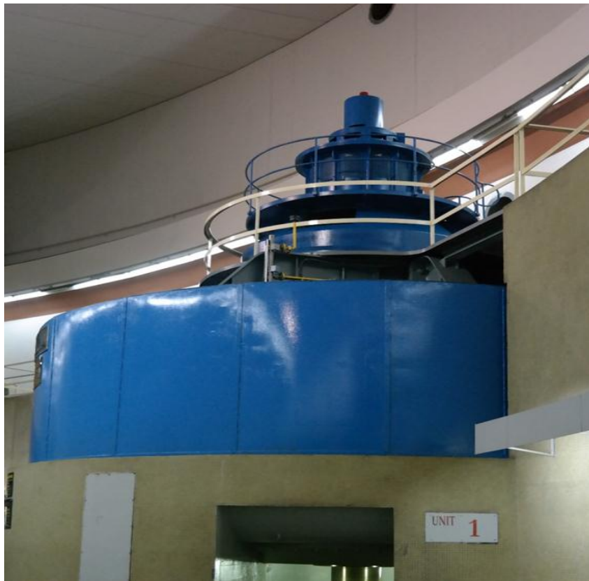
Gambar 4.1 Generator GEC ALSHTOM PLTA Ir. H. Djuanda Jatiluhur
