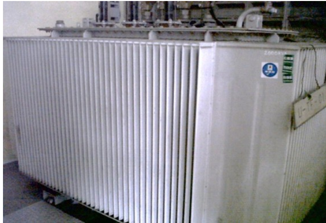
Gambar 2.3 Transformator Step Down (Sumber: dokumentasi pribadi)
