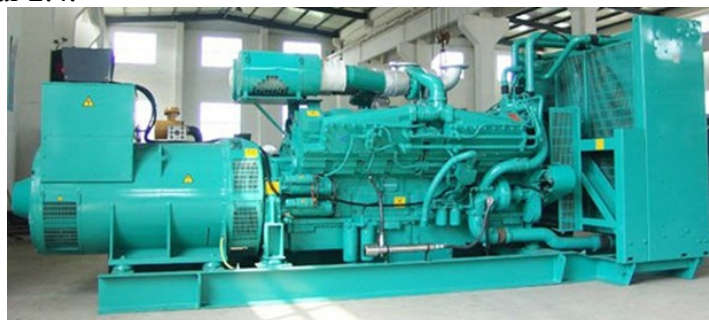
Gambar 2.4 Generator Set (Genset) (Sumber: dokumentasi pribadi)
