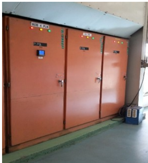
Gambar 2.5 Panel listrik (Sumber: dokumentasi pribadi)
