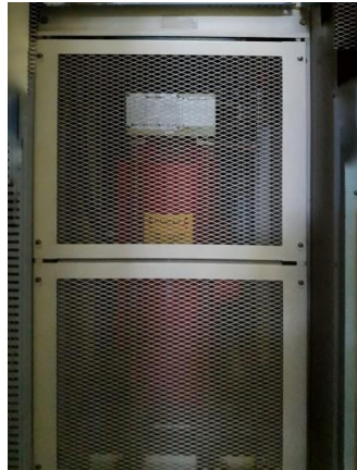
Gambar 4.2 Transformer Excitation PLTA Wonogiri (Sumber : Dokumentasi Pribadi)
