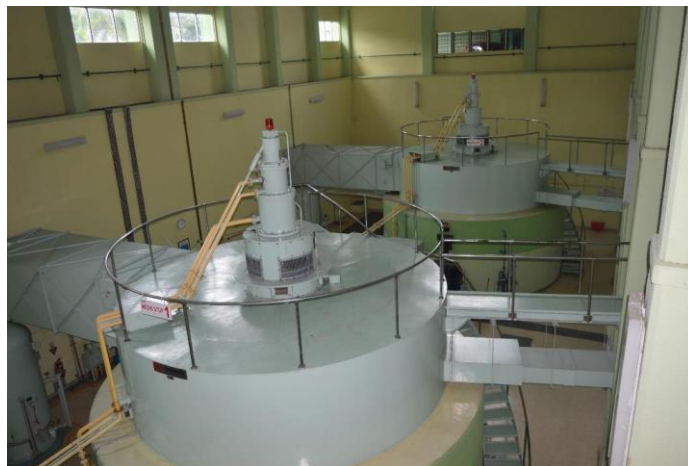
Gambar 2.6 Generator unit 1 dan 2 PLTA wonogiri ( Sumber : Dokumentasi PLTA Wonogiri )
