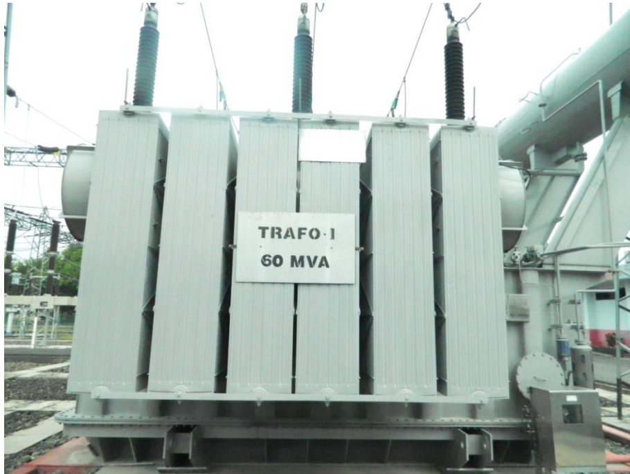
Transformasi 1 Gardu Induk 150 kV Bantul
