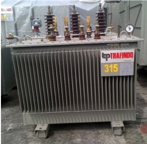
Gambar 2.2 Transformator Step Down (sumber www.elektronik.pelapak.com )
