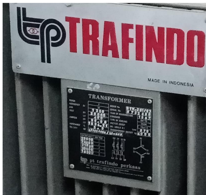
Gambar 4.7 Name Plate Transformator Tenaga Yang Menyuplai Gedung AR Fakhruddin
