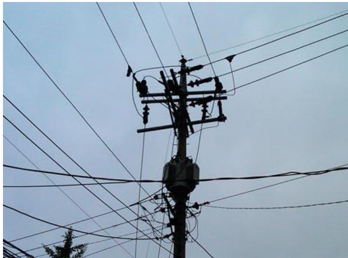
Gambar 2.3 Saluran kabel udara tegangan menengah
