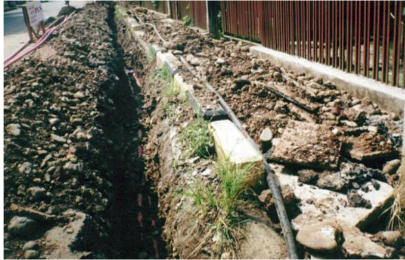
Gambar 2.4 Saluran kabel tegangan menengah
