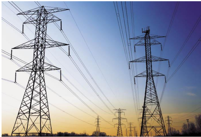
Gambar 2.1 Saluran udara tegangan ekstra tinggi
