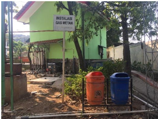
Tempat Instalasi Gas Metan di TPA Jatibarang
