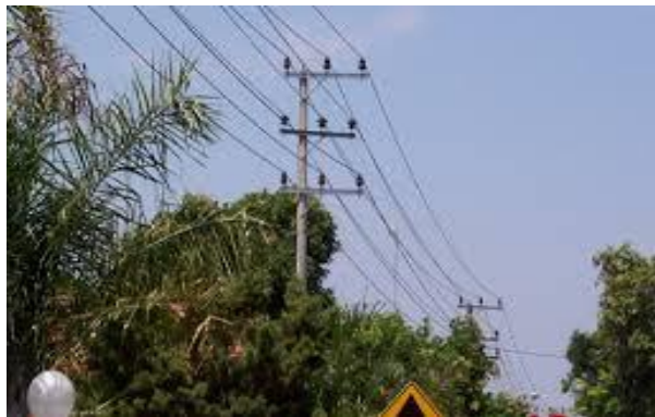
Gambar 2.5 Saluran udara tegangan menengah (SUTM)
