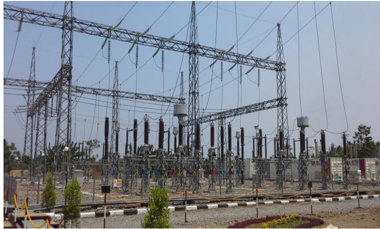
Gambar 2.4 Gardu induk pemasangan luar
