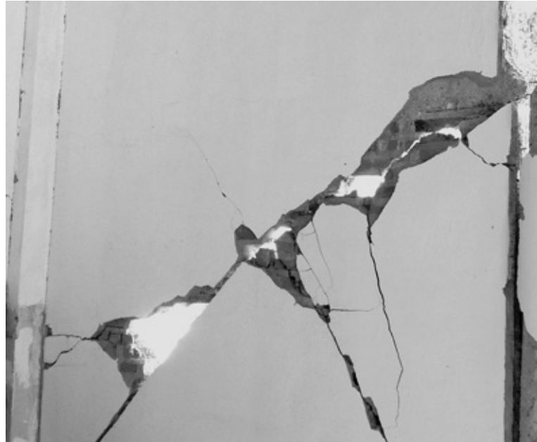
Gambar 7. Kerusakan pada Dinding Masjid Al-Iman.
