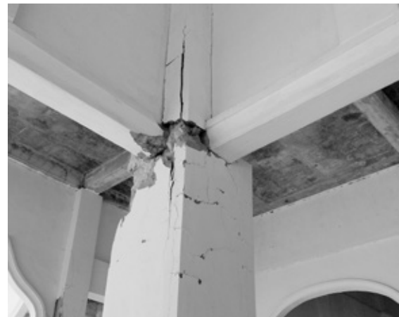
Gambar 6. Kerusakan pada Sambungan Balok Kolom.
