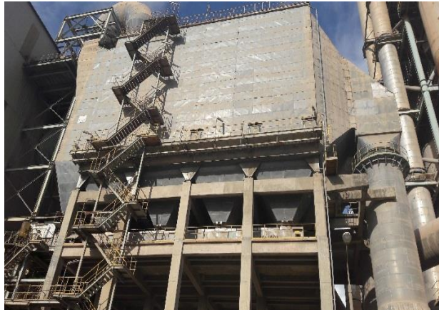
Gambar 2.1 Electrostatic Precipitator pada Raw Mill PT Indocement Tunggal Prakarsa, Tbk Plant-12 Tarjun
