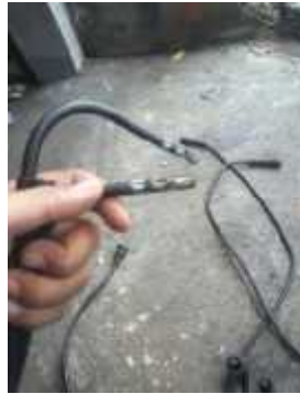
Gambar 4.8 Kondisi kabel tegangan tinggi1
