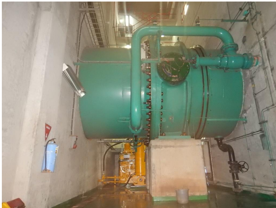
Gambar 3.2. Foto Perangkat Main Inlet Valve (Sumber : PLTA PB SOEDIRMAN, 2017)
