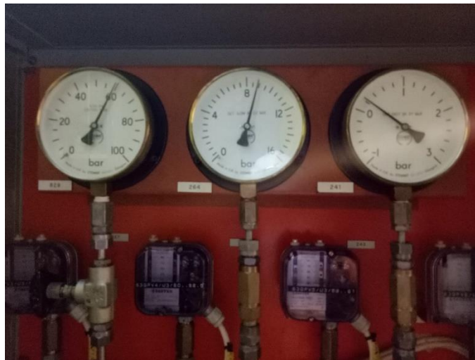
Gambar 3.3. Foto Pressure Switch dan Indikator (Sumber : PLTA PB SOEDIRMAN)
