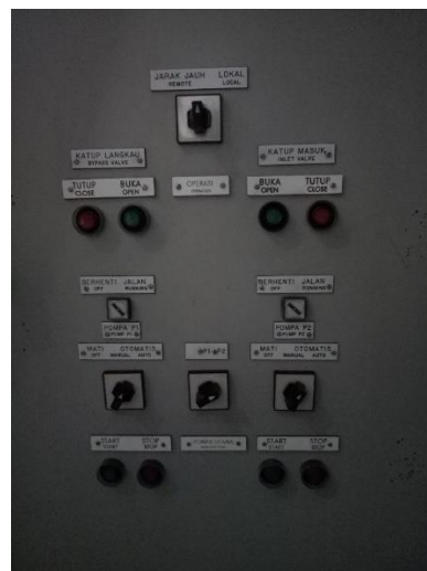
Gambar 3.4. Foto Panel Kontrol Sistem Main Inlet Valve (Sumber : PLTA PB SOEDIRMAN, 2017)
