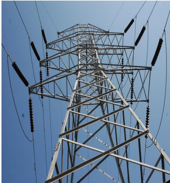
Gambar 2.2 Saluran udara tegangan tinggi
