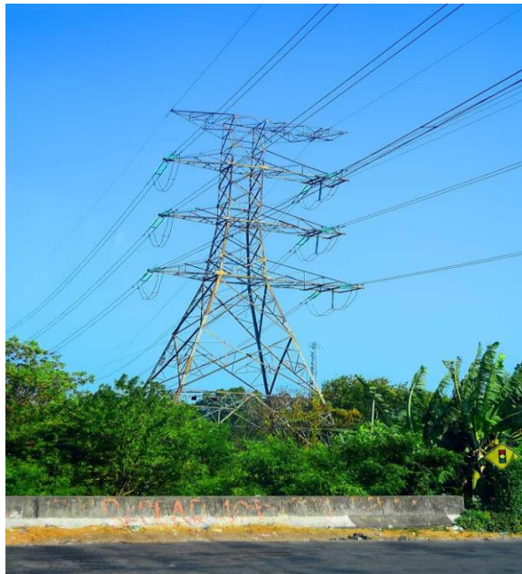
Gambar 2.1 Saluran udara tegangan ekstra tinggi
