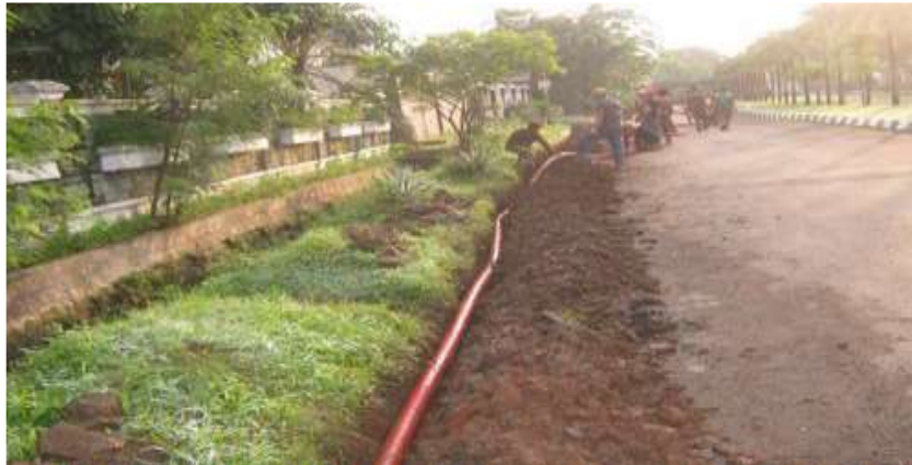
Gambar 2.2 Saluran Kabel Tegangan Menengah
