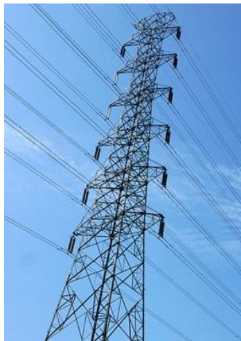
Gambar 2.2 Saluran Udara Tegangan Ekstra Tinggi
