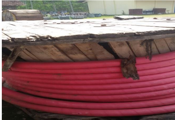
Gambar 2.6 Saluran Kabel Tegangan Menengah
