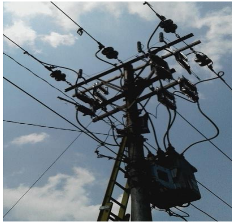
Gambar 2.5 Saluran Kabel Udara Tegangan Menengah
