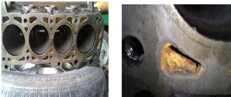
Gambar 4.6 Kondisi awal pada Water jacket
