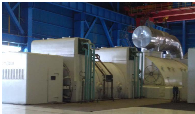
Gambar 2.3. Generator PLTU Cilacap
