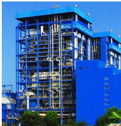
Gambar 2.1. Boiler PLTU Cilacap
