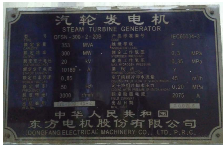
Gambar 2.10. Spesifikasi Generator PLTU Cilacap
