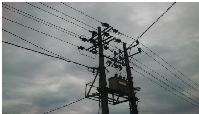
Gambar 2.4 Saluran Kabel Udara Tegangan
