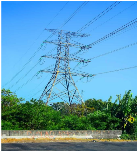
Gambar 2.1 Saluran udara tegangan ekstra tinggi
