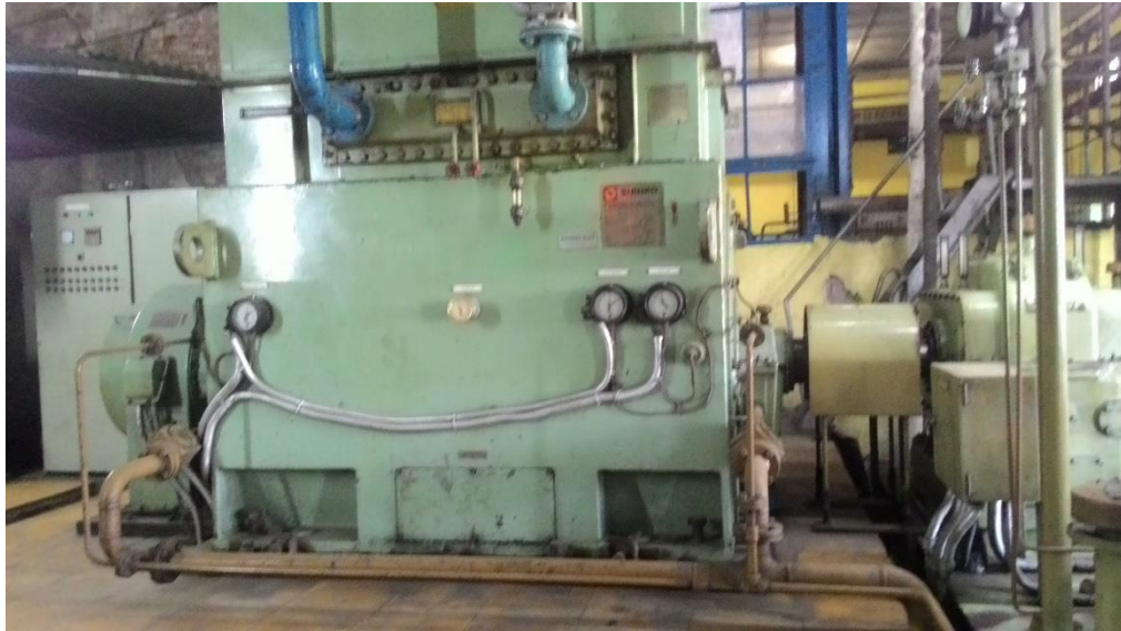
Gambar 4.1 Generator Biomassa 2.000 KW di PG. Pangka
