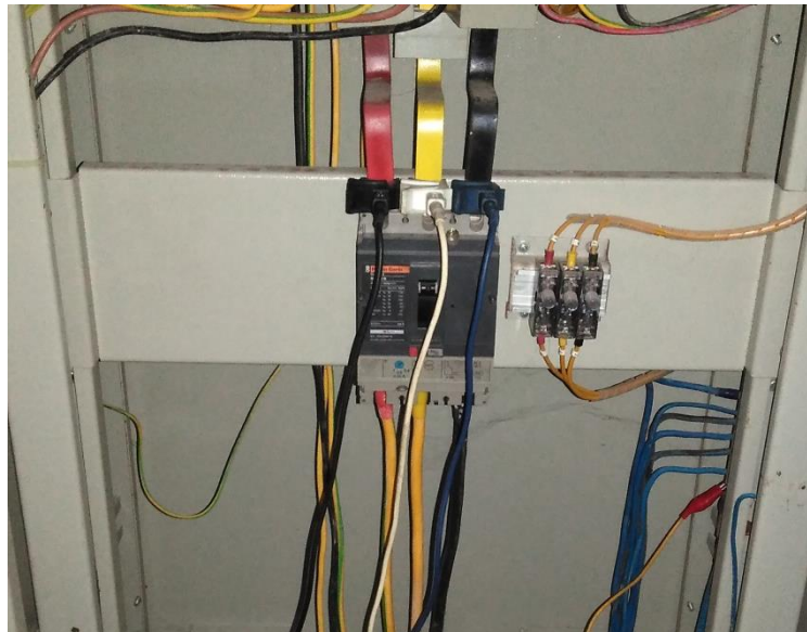
Gambar 3. 5 Jumper pada fasa R,S,T
