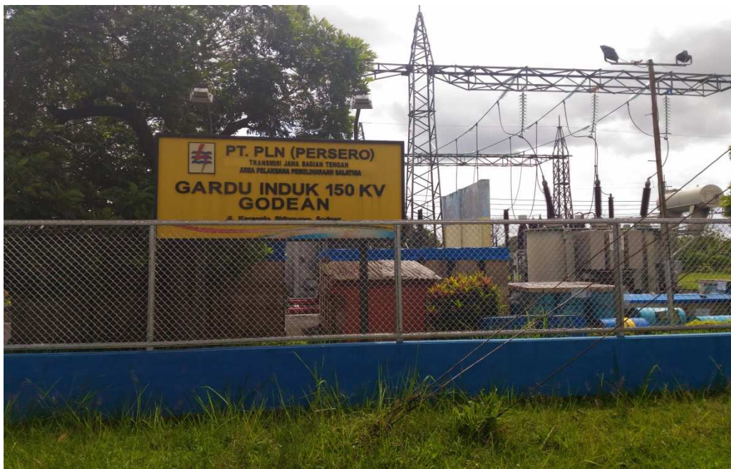
Gambar 2.1 Transformator Daya pada Gardu Induk Godean
